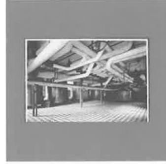
[51] Rohrkeller einer Abwärmeverwertungszentrale auf der Zeche Auguste Victoria in Hüls bei Recklinghausen, aus dem Archiv Opländer
