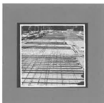
[101] Im Bau befindliche Deckenstrahlungsheizung, die Rohre liegen auf der Schalung, aus dem Archiv Opländer
