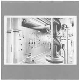
[113] Schalt- und Regelzentrale für eine Klimaanlage, aus Opländer Firmendruckchrift 7/75/BU
