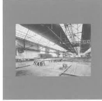
[50] Beheizung der Weichenwerkstätte durch Lufterhitzer in der Maschinenfabrik Deutschland in Dortmund, aus dem Archiv Opländer
