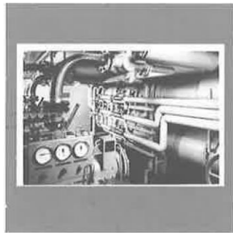
[112] Kälteversorgung für Klimaanlage, aus Opländer Firmendruckchrift 7/75/BU
